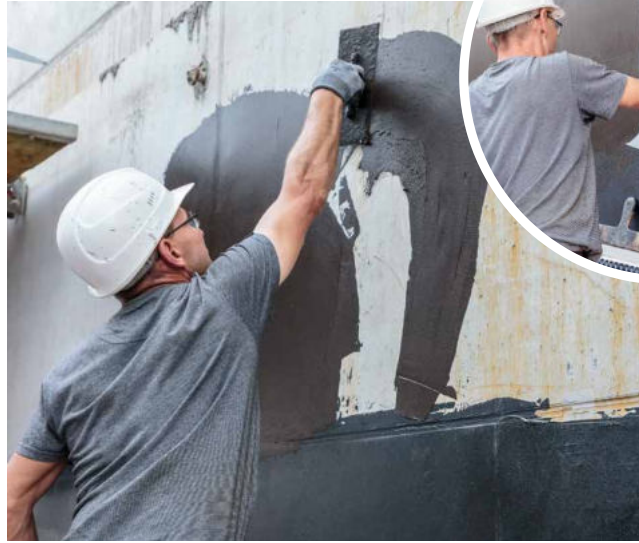
工匠师傅使用聚合物改性沥青为地下室墙壁做防水密封处理。
