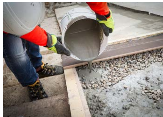
自充填混凝土技术为大面积修复提供了低成本解决方案，具有巨大的优势。
