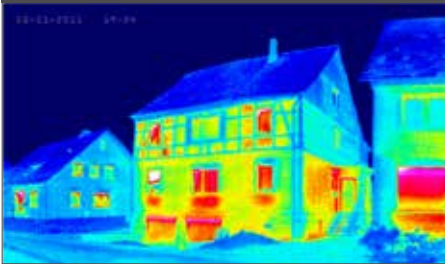
Figura 2: Imagen térmica de las fachadas: Los edificios a la izquierda y a la derecha están bien aislados, el del medio no lo está.
