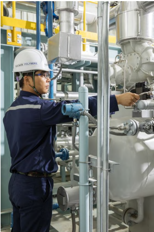
一位技术工人正在检查和维护新设备（图片：瓦克）
