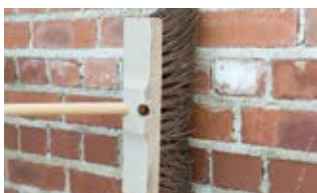
5.) Salze abkehren oder Sanierputz applizieren.
