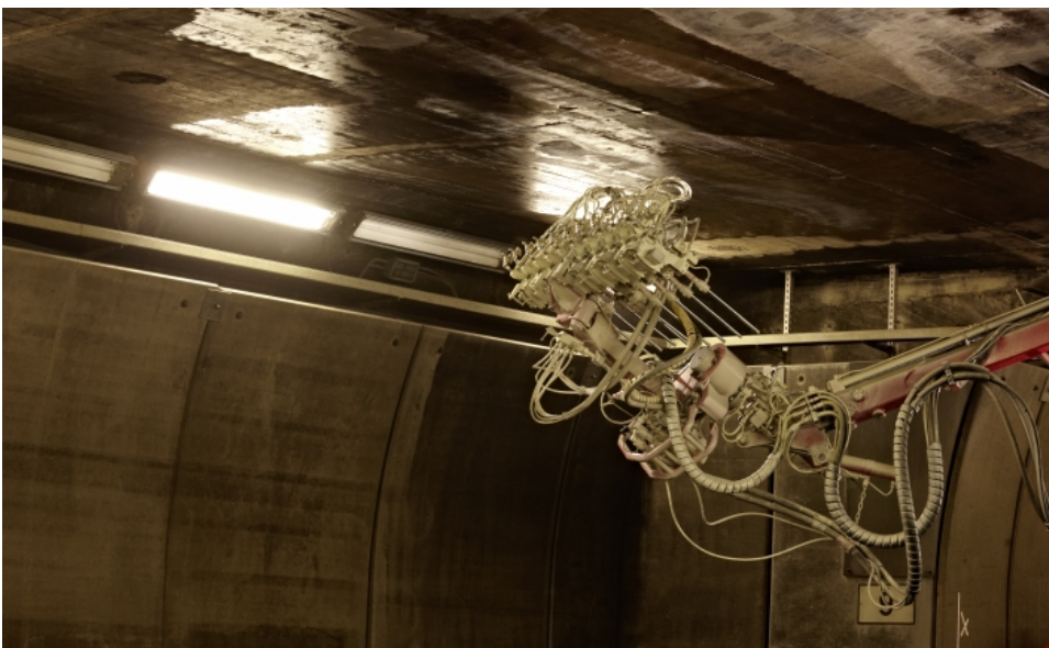
Sanierungsarbeiten im Gotthard-Tunnel: Fachkräfte applizierten die Silan-Imprägnierung mittels Druckluft. (Foto: Wacker Chemie AG)
