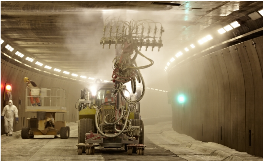
Vollsperrung: Die Decke des Gotthard-Tunnels wurde Ende September zum Schutz gegen Feuchtigkeit und Salzeintrag mit einer speziellen Silancreme des Münchner Chemiekonzerns WACKER imprägniert. (Foto: Wacker Chemie AG)
