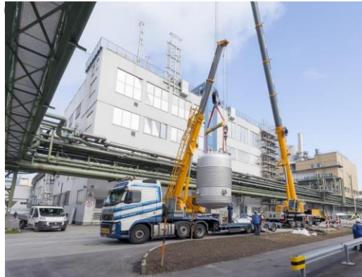
Vormischbehälter für neuen Dispersionsreaktor in Burghausen
