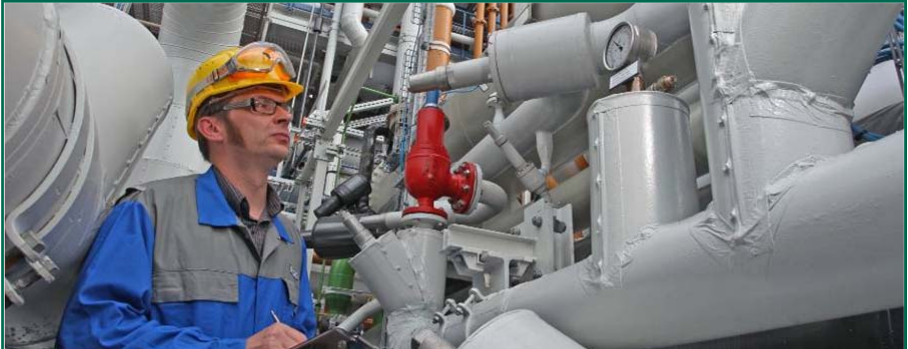
Kreisgasanlage in der Polysiliciumproduktion
