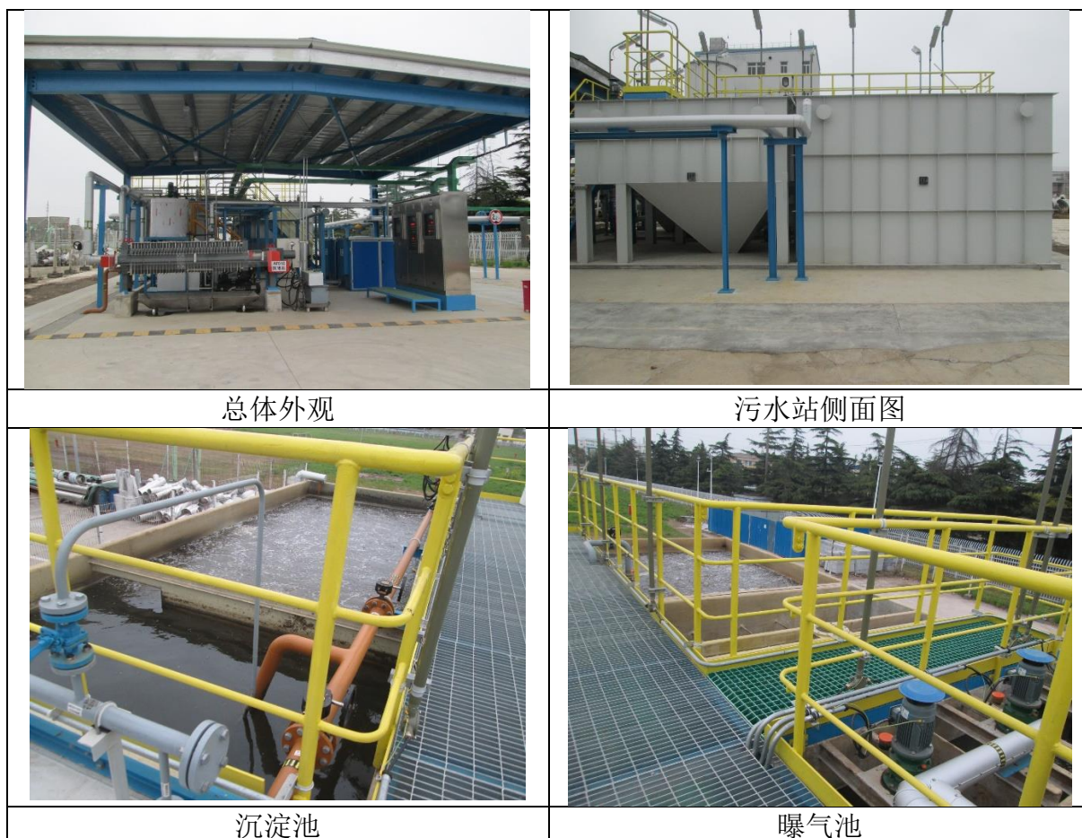
图 4.1-2 污水站现场照片
