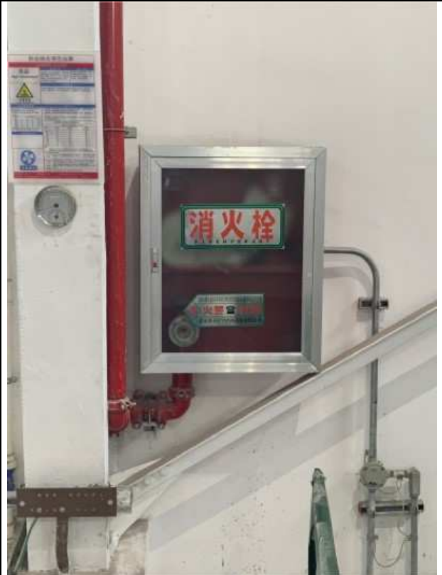
内部消防设施
