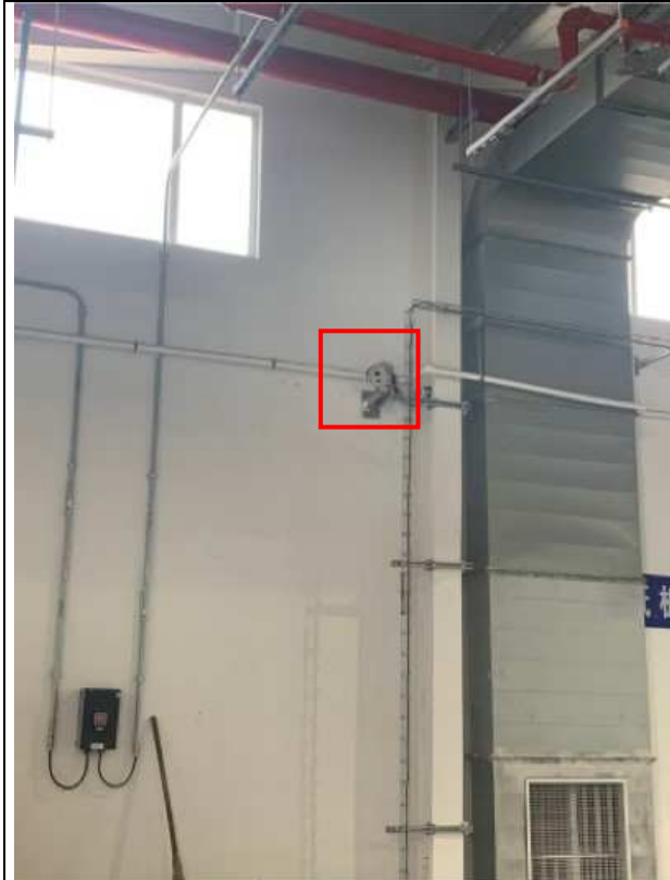
内部监控设施 1
