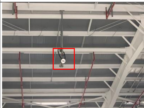
内部监控设施 2
