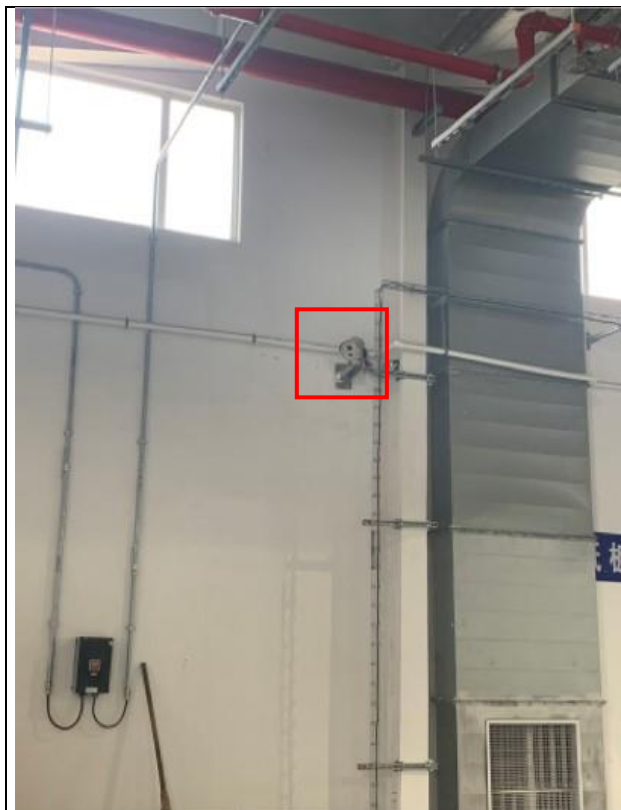
内部监控设施 1
