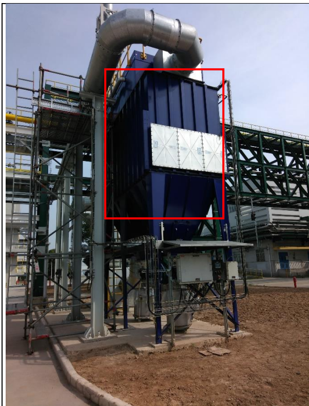
8#排气筒除尘器
