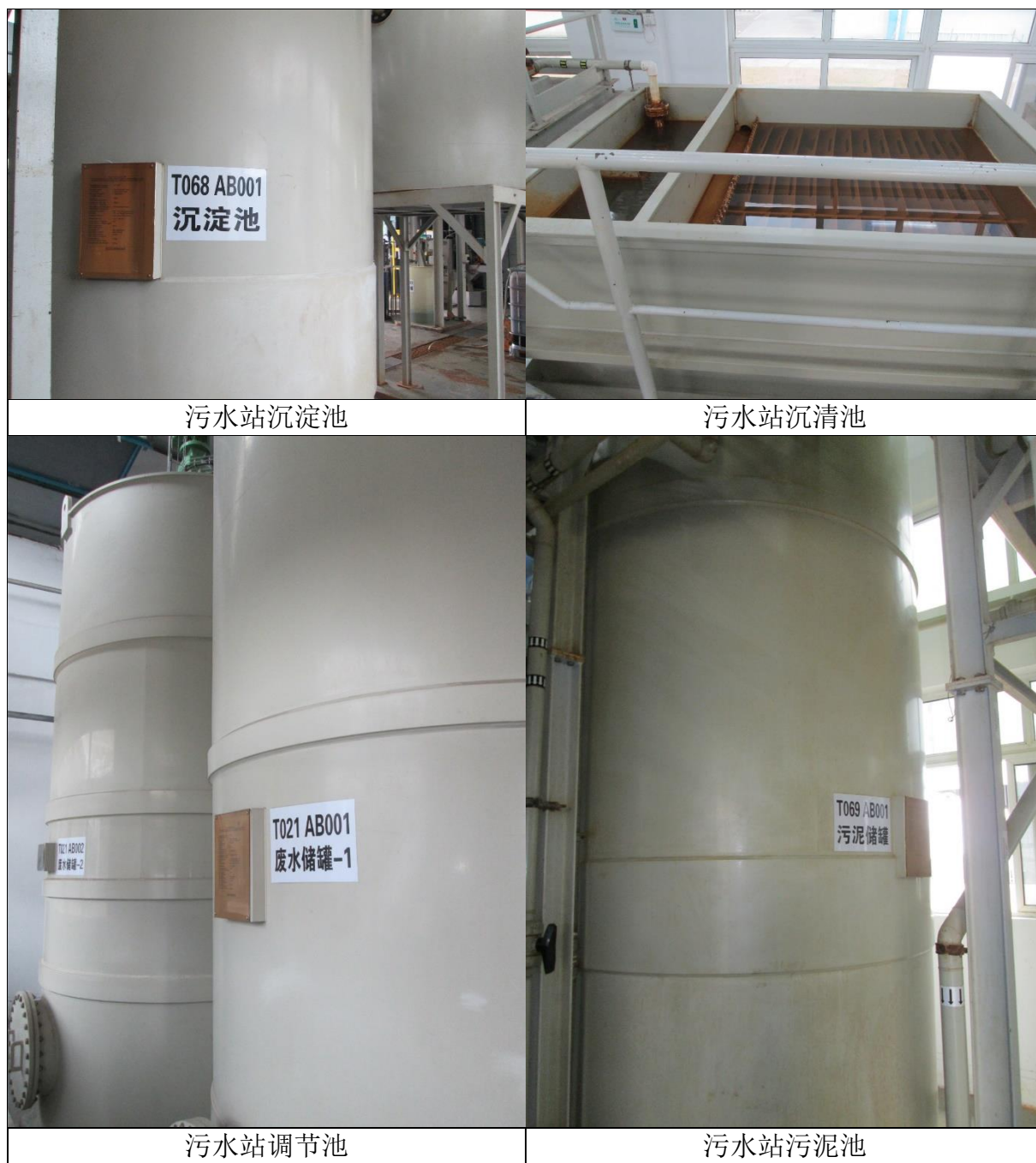
图 4.1-2 厂内污水站及排放口现场照片
