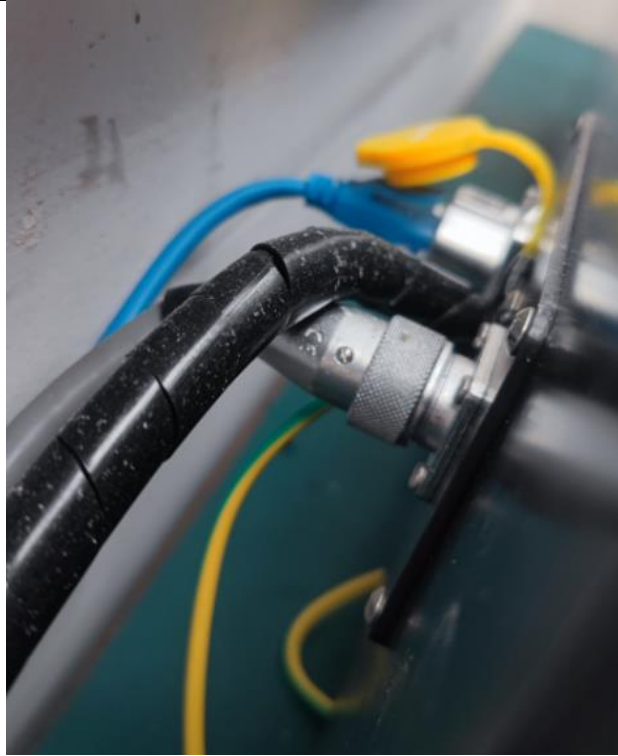
图 3-8 设备电脑、网线连接照片
